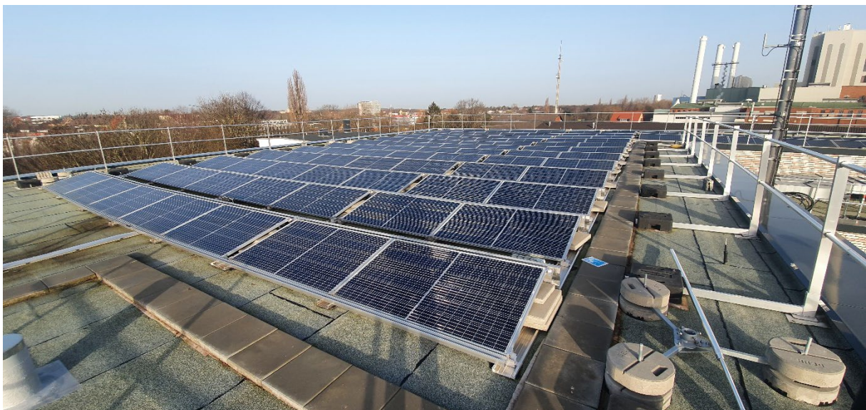
Foto zu 1.4.6: PV-Anlage auf der Feuerwehrleitzentrale (© Stadt Braunschweig, Steffen Trudewig)
