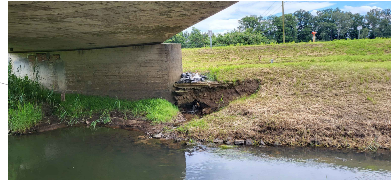
Schadstelle Viehtritt nach Sofortmaßnahme, unverändert 13. Juni 2024
